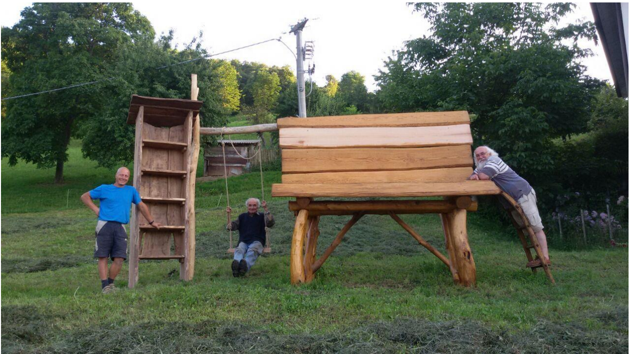
Nella foto da sinistra: Cristian, Trumlin e Giorgio al termine dei lavori per la costruzione della panchina e della biblioteca a Baracco nell'estate del 2016.
